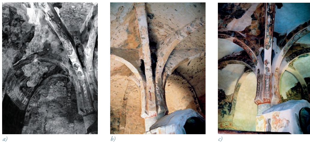
Figura 1. Vista de la «palmera»: a) Situación antes del arranque, en 1965; b) después de retacar la bóveda, en 2001; c) una vez reubicadas las pinturas, en 2002. Fotos del IPHE.
