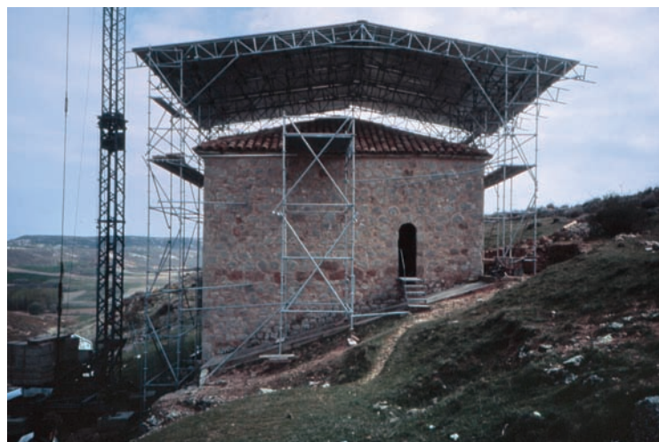
Figura 6. Instalación de una sobrecubierta de andamio para permitir la restauración arquitectónica (foto Yusta, 2000).
